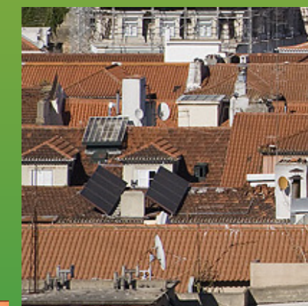
Colectores solares térmicos existentes (Fonte: Velux)
